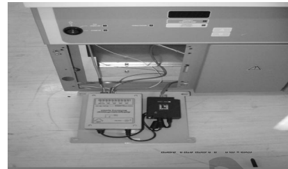
รูปภาพที่ 8 แสดงการติดตั้งหัววัดอุณหภูมิภายในตู้เก็บเซิร์ฟเวอร์
